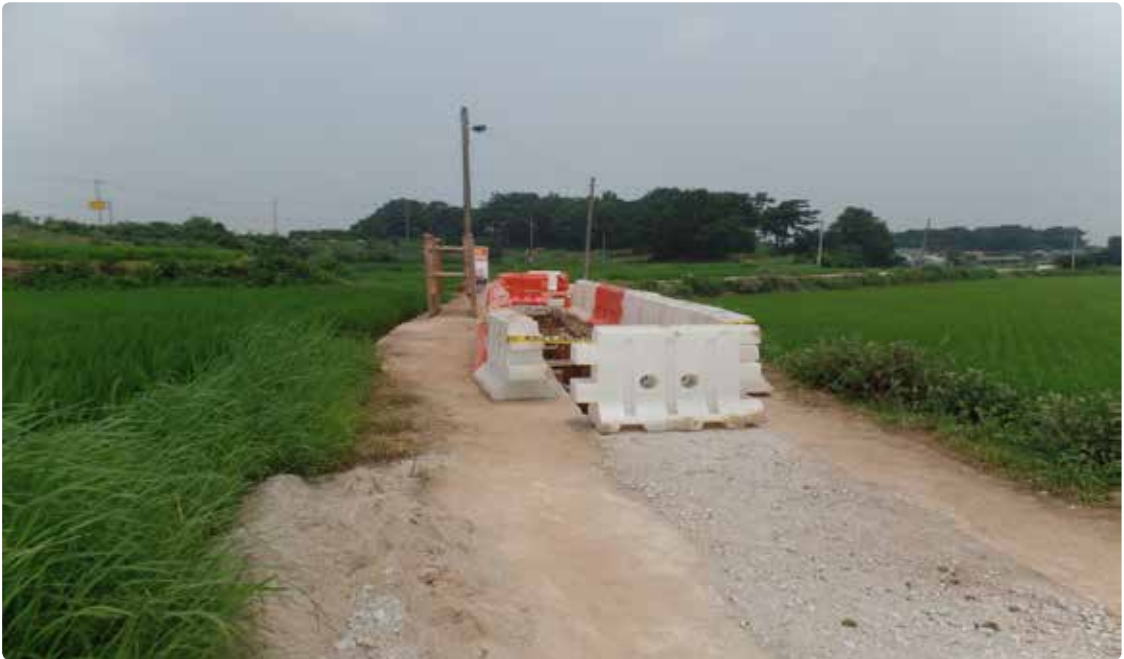
[사진1] 재해발생 현장 전경
