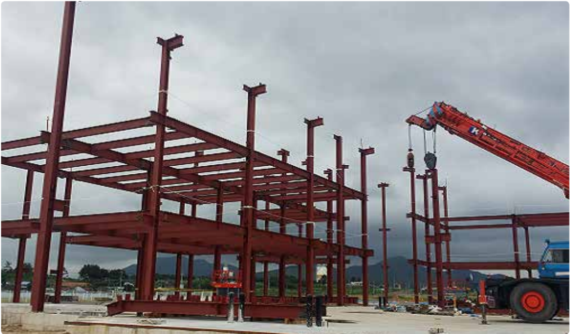
[사진1] 재해발생 현장 전경
